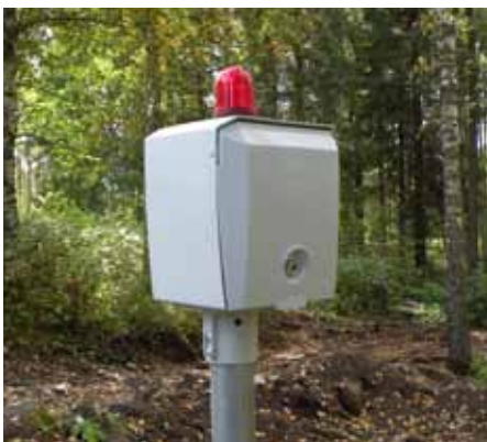
Sähkö- ja ohjauskeskus
